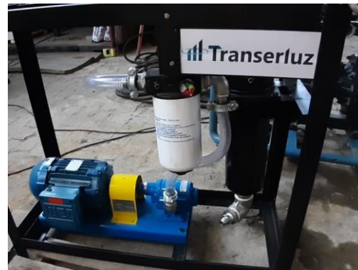
Unidade de Filtragem de Óleo
