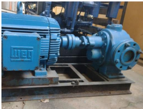
Unidade de Flushing
