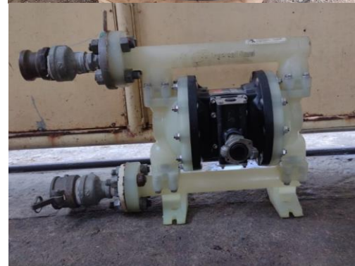
Unidade de Limpeza Química
